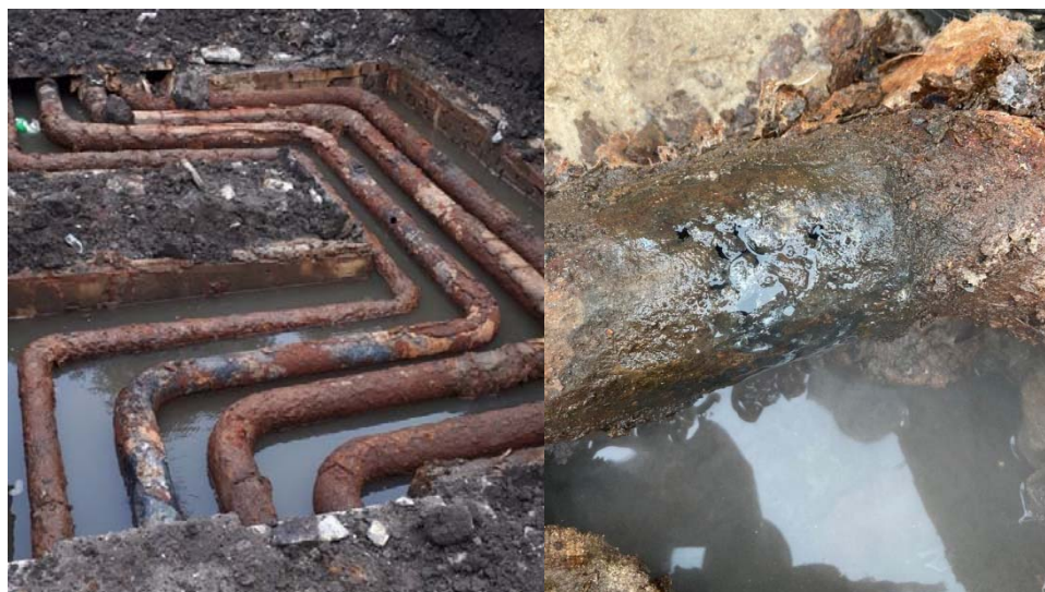
Рис. 2. Сквозная коррозия тепловых сетей в непроходных каналах
