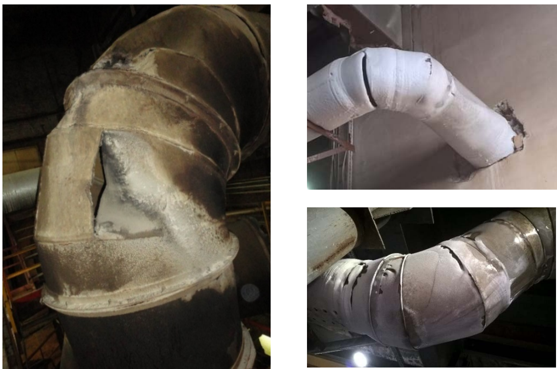
Рис. 1. Неплотность в отводе
