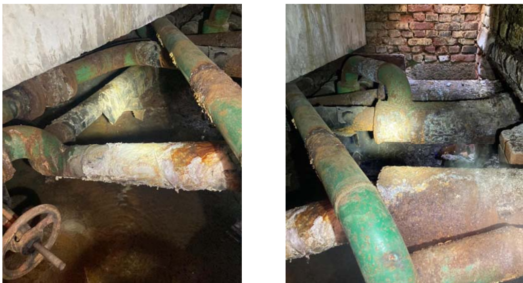
Рис. 3. Коррозия трубопроводов в тепловых камерах
