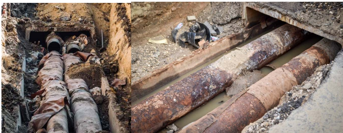
Рис. 1. Коррозия тепловых сетей в непроходных каналах
