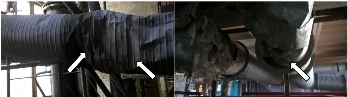
Рис. 3. Нарушение заводской конфигурации прямого участка воздуховода
